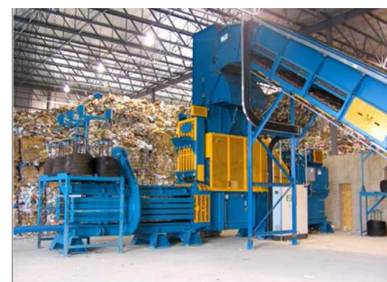
Presse à balles du matériel récupéré
