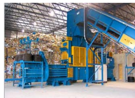
Recovered Material Baler / Presse à balles du matériel récupéré
